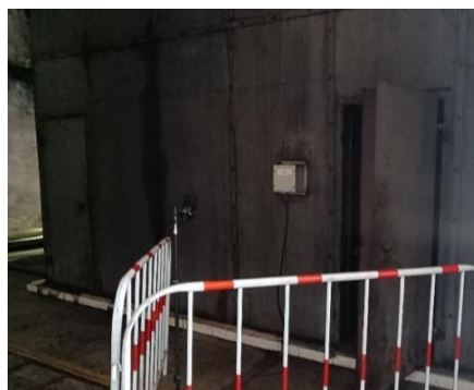
图5 光纤麦克风安装位置
